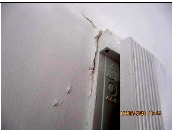
8. גימור לקוי לחלוטין
